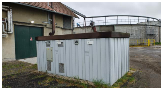
Obrázek – Objekt kogenerace s trafostanicí
